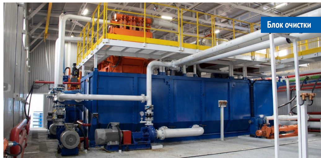
Оборудование системы очистки
