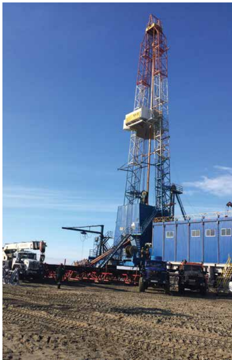
Модернизация буровой установки БУ3000ЭУК-1М на Восточно-Мессояхском месторождении (ЯНАО) для ООО «Буровая компания «Евразия»
