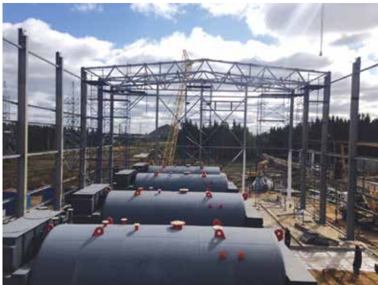
Строительство автоматизированной паровой котельной установки производительностью 220 тонн пара в час на Ярегском нефтяном месторождении (Республика Коми) для «ЛУКОЙЛ - Коми»
